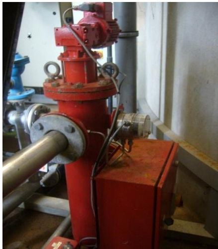
Le système de filtrage
