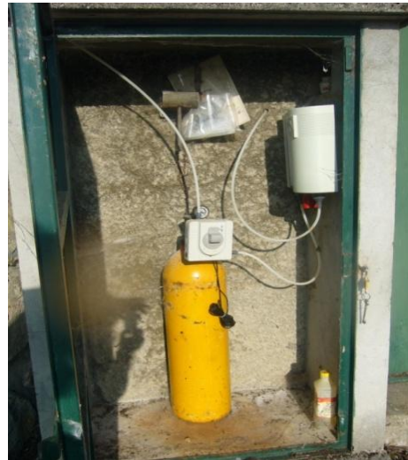
Le traitement par le chlore
