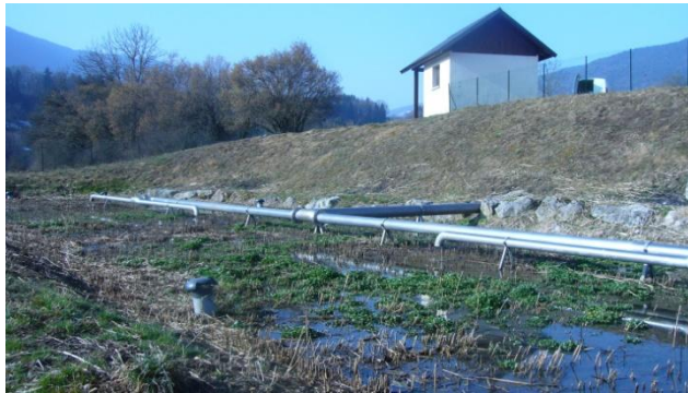
Le local technique et le premier bassin
